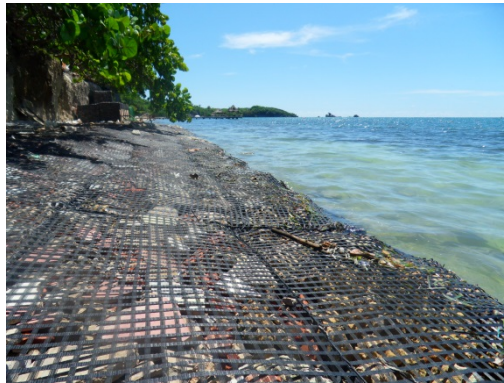
Fotografía 8. Protección de orillas costeras con colchones de enrocado confiando con geomallas de poliéster.
