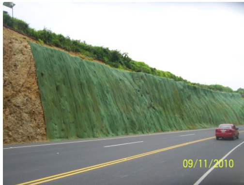
Fotografía 3. Control de caída de detritus con mantos permanentes para control de erosión.
